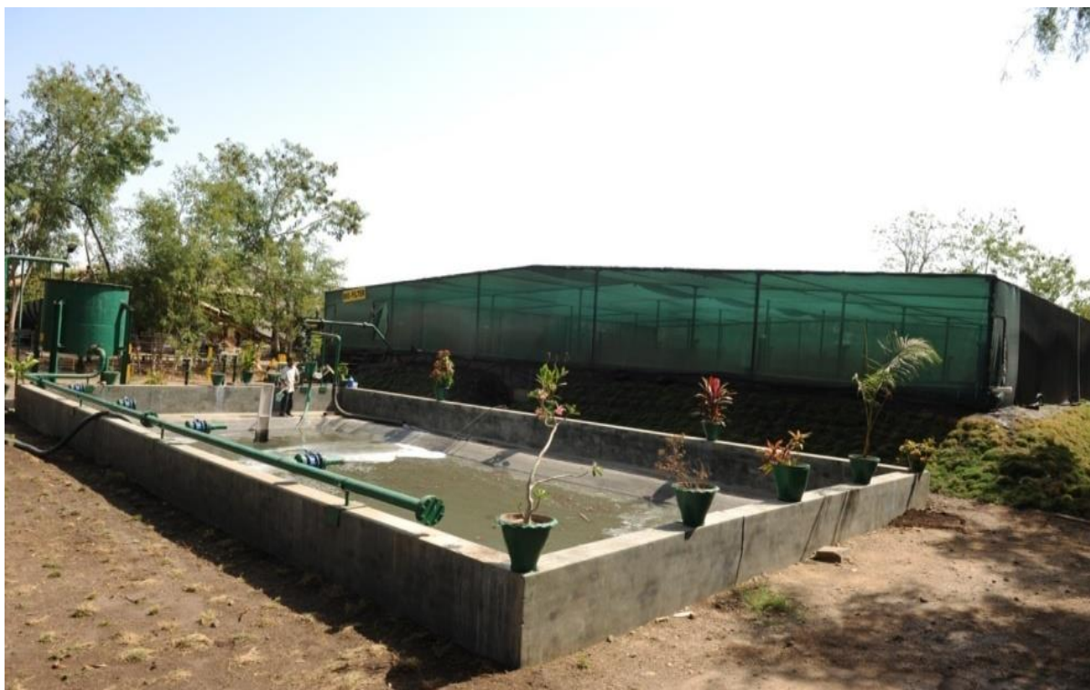
Рис. 14 – Установка по вермифильтрации сточных вод производительностью в 200 тонн в сутки (Sinha, 2012).
