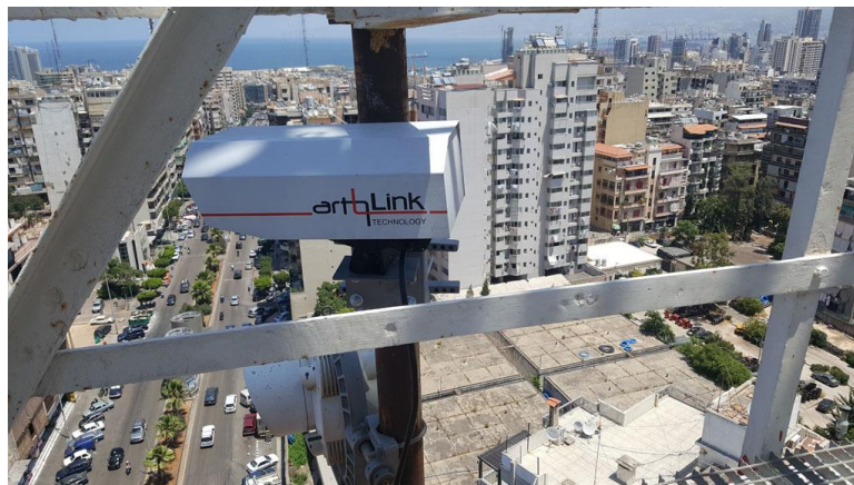
Рисунок 1.1 – Оборудование атмосферной оптической связи, смонтированное на уровне крыши дома [6]
